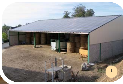
Hangar de stockage et panneaux photovoltaïques.
