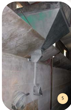
Arrivée du concentré par vis en bout de couloir des veaux, et déflecteur.
